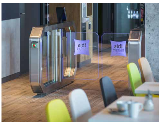
CONTRÔLE D'ACCÈS à la salle de petit-déjeuner
